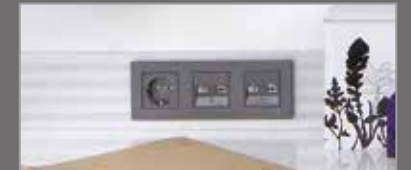
Kablo Kanalı, Priz
